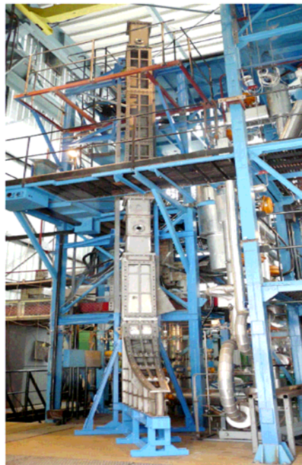
Abbildung 6-2: Gesamtansicht der CERES-Versuchsanlage in der Halle der PMK-2 ohne Heizung und Isolation
