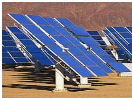
Bild 23: Sonnenkollektoren in Herzogenburg
