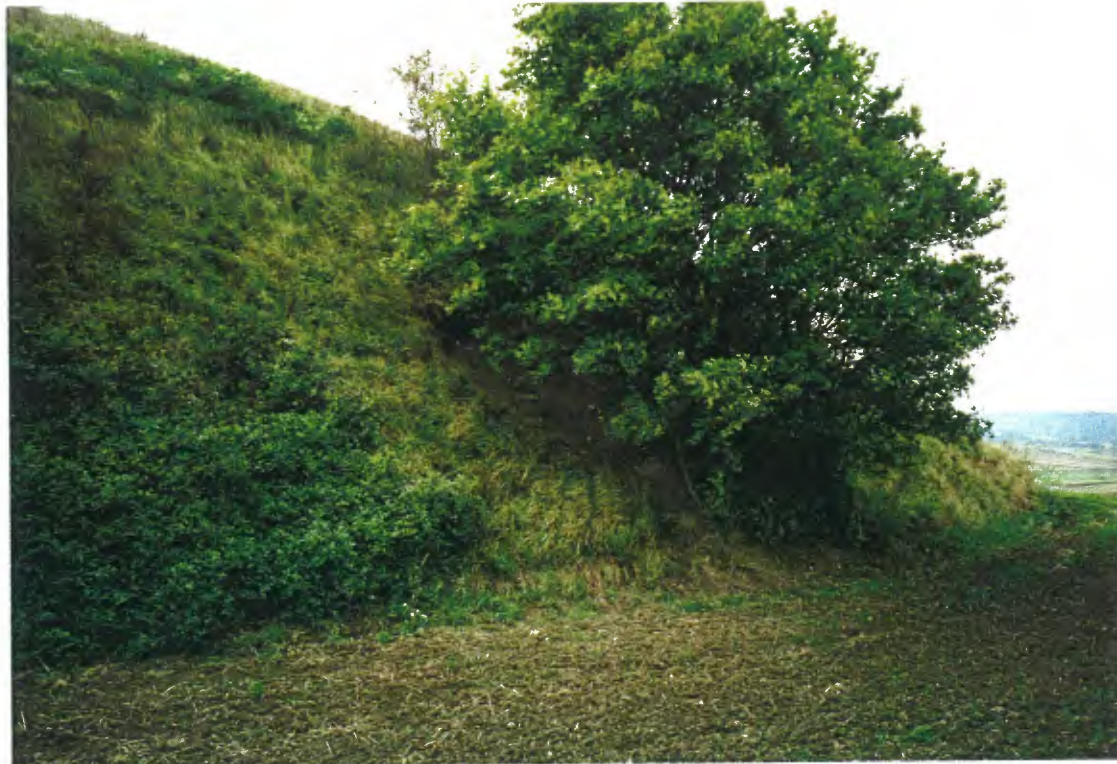
Verbuschung im Fußbereich
